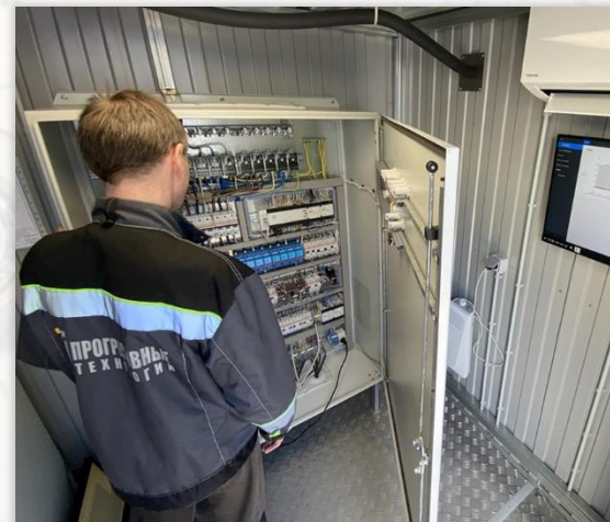
Щит собственных нужд
